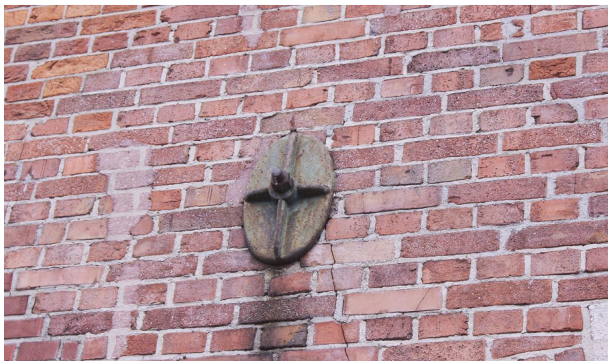
Rozetanker in een van de gevels.
