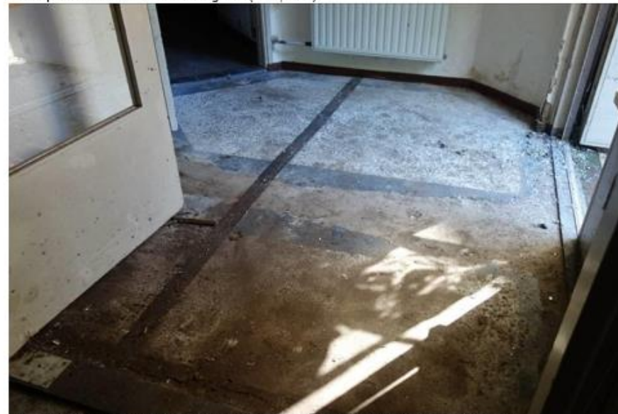
Restanten van de granito vloer bij de noordelijke entree van het hoofgebouw. (MAB, 2019)
