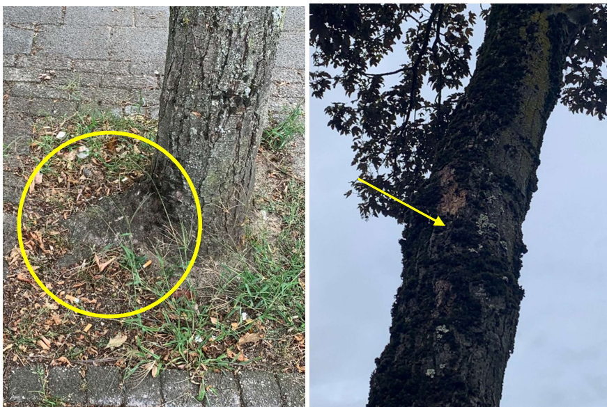
Foto 2 en 3: in de gele cirkel de overontwikklde wortel, de stam aan de straat zijde laat geen wortelaanlopen zien. Waarschijnlijk is di teen geënte boom en is er reële kans op uitgestelde onverenigbaarheid.
